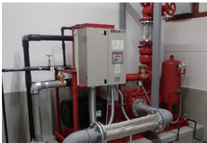
▲スプリンクラーポンプ
