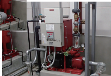
▶屋内消火栓ポンプ
