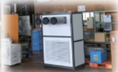
移動式レンタルスポットエアコンで現場の暑さ対策!
